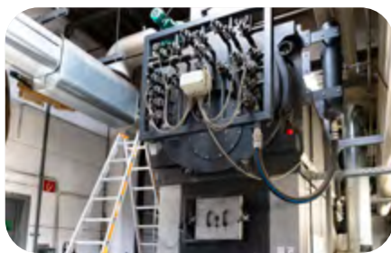
Holzverbrennungsanlage zum Heizen
