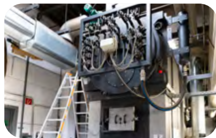
Holzverbrennungsanlage zum Heizen
